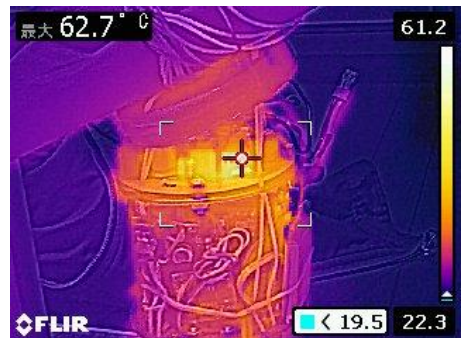
図9 基板の発熱状態
